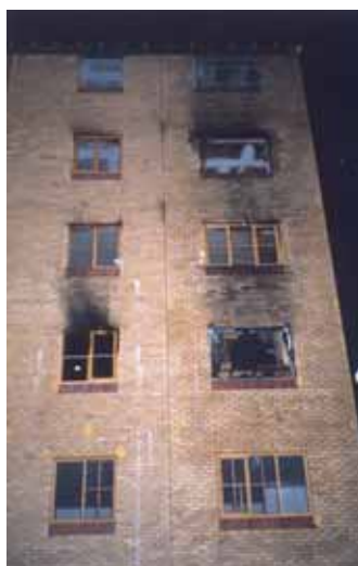
Obr. 4: Část severní fasády po požárních experimentech
