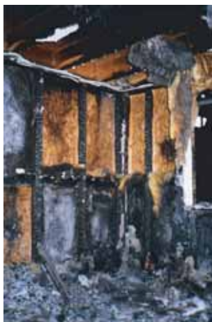
Obr. 7: Interiér po 60minutovém požáru
